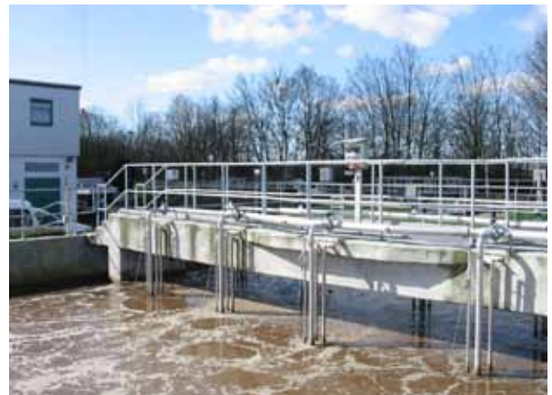
Sauerstoffeintrag in das Belebungsbecken einer Kläranlage
